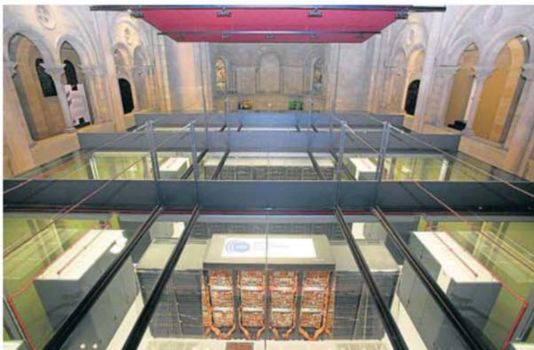
Els sistemes de refrigeració suposen el 40% de la despesa energètica dels centres de computació. MANOLO GARCIA
